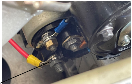
Punto de conexión del cable positivo (+) de la batería del motor diésel Kohler.
