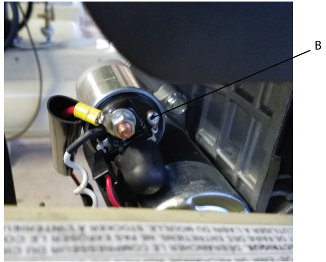
Punto de conexión del cable positivo (+) de la batería del motor diésel Yanmar.
