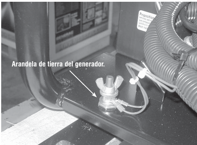
Figura 13 - Conexión a tierra del generador
